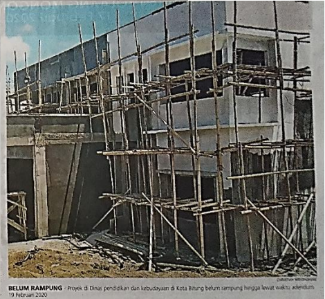
BELUM RAMPUNG - Proyek di Dinas pendidikan dan kebudayaan di Kota Bitung belum rampung hingga lewat waktu adendum 19 Februari 2020.
