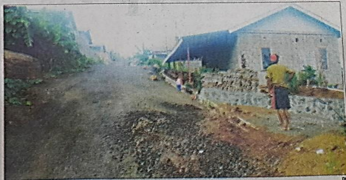
DIKELUHKAN: Jalan aspal lapen yang mengalami kerusakan di perumahan relokasi bencana Pandu.
